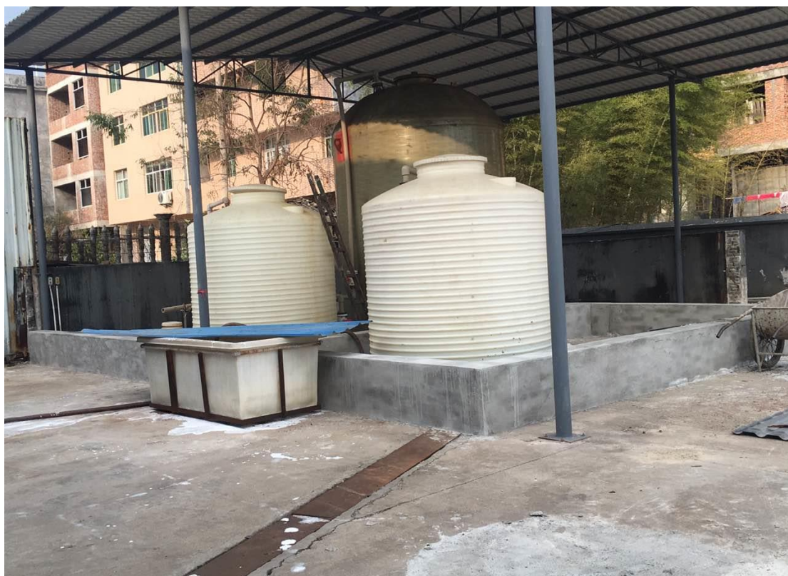
图 4.2-1 盐酸、液碱储罐
